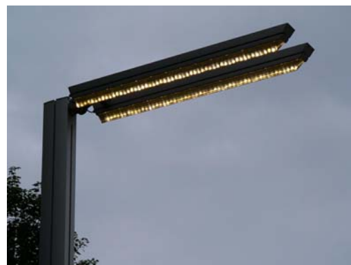
neue Hess-LED-Leuchte zur Beleuchtung von Anlieger- und Sammelstraßen
